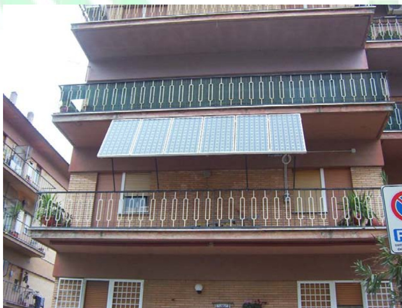
Figura 23 - Esempio di installazione non idonea alla classificazione dell'impianto fotovoltaico nella categoria "su edifici" – Motivazione: la lunghezza dell'impianto fotovoltaico supera il doppio della lunghezza delle aperture trasparenti sottese
