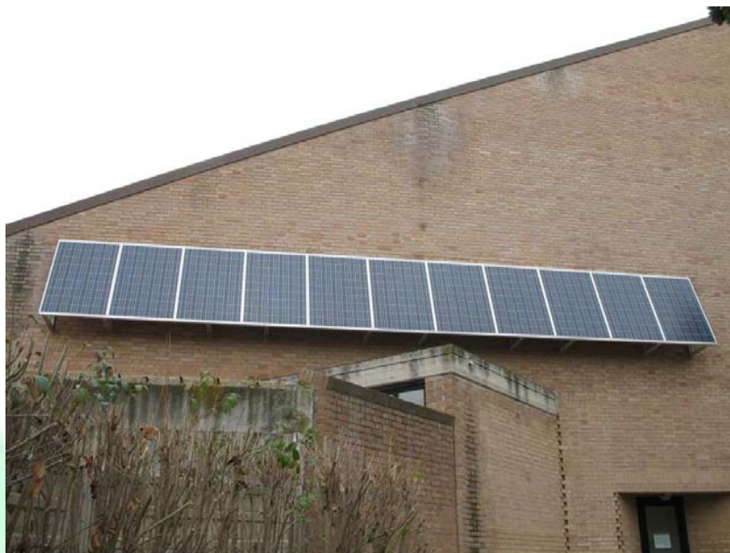
Figura 24 - Esempio di installazione non idonea alla classificazione dell'impianto fotovoltaico nella categoria "su edifici" – Motivazione: la struttura collegata non sottende superfici trasparenti
