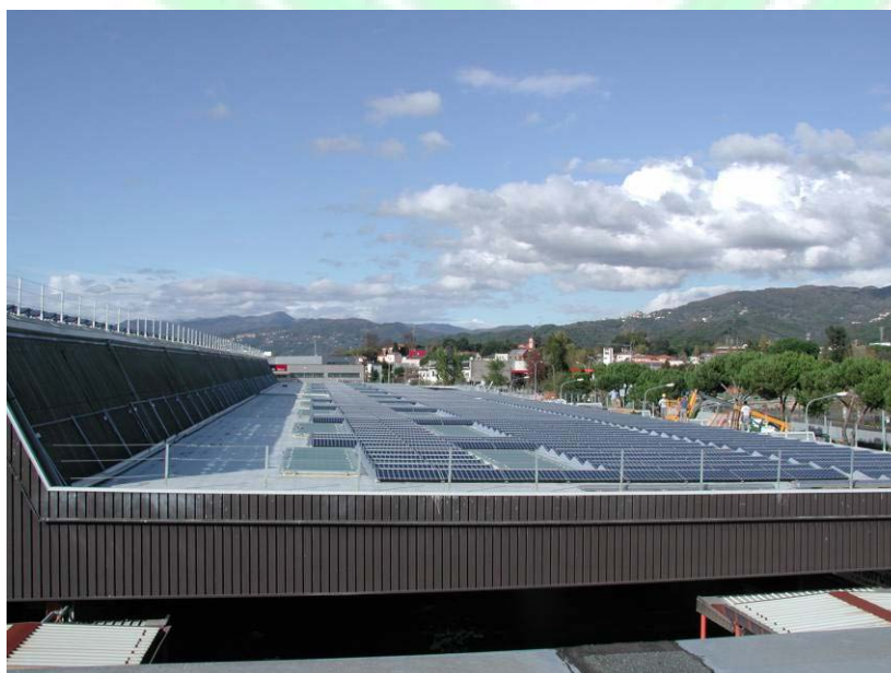
Figura 2 – Esempio di installazione idonea alla classificazione dell'impianto fotovoltaico nella categoria "su edifici" in caso assenza di una balaustra perimetrale
